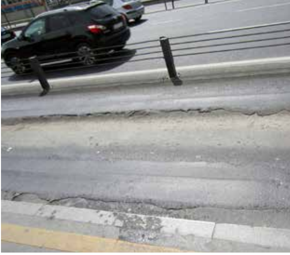
Şekil 18 Bazı istasyonlardaki tekerlek izi (rutting) ve benzeri yol bozuklukları
