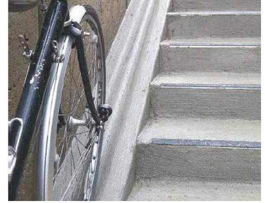
Şekil 89 | U Şeklinde Beton Bisiklet Merdiven Kanalı
